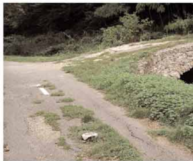
Enrobé en mauvais état
