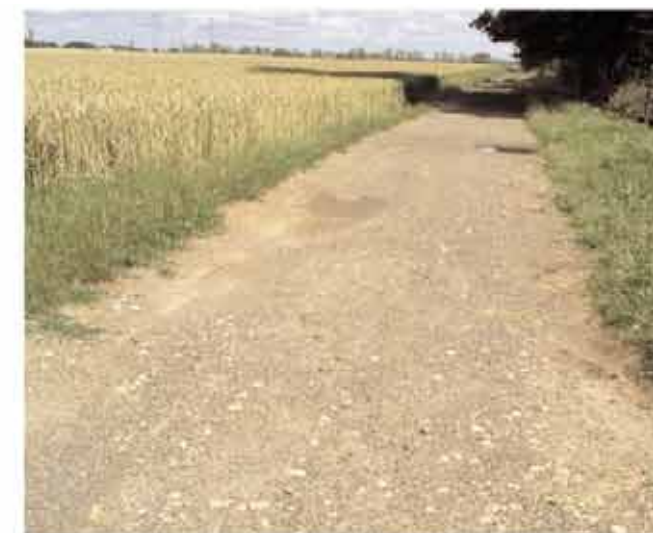
Grave en mauvais état
