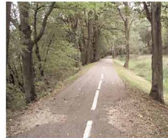
Enrobé en mauvais état
