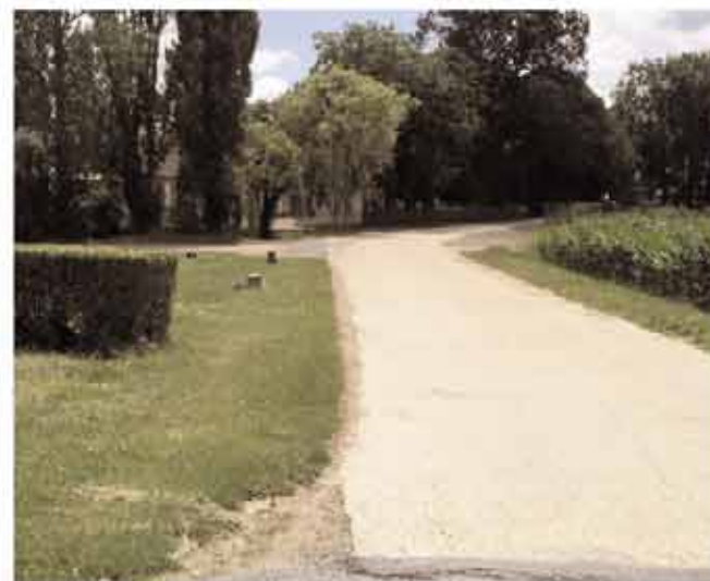
Béton en état moyen
