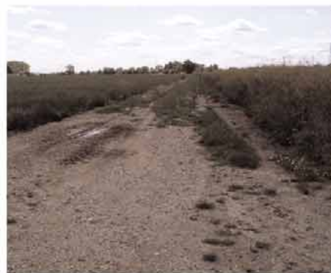
Chemin enherbé en mauvais état
