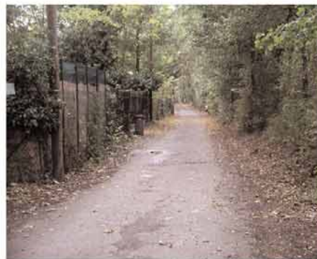
Enrobé en état moyen
